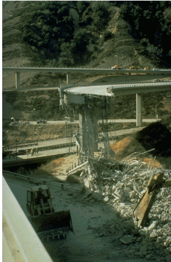
Abbildung 3.7: Einsturz einer Brücke in der North San Fernando Valley, Northridge Erdbeben 1994
