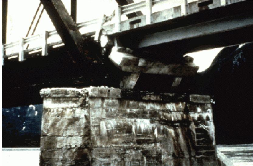
Abbildung 3.1: Schaden am Auflagerbereich einer Eisenbahnbrücke, Alaska Erdbeben, 1964
