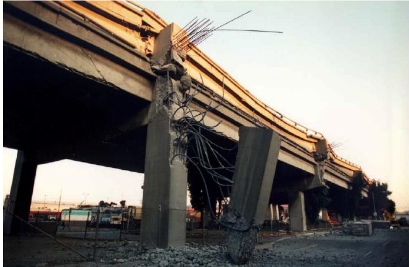
Abbildung 3.3: Einsturz von Betonstützen (zweistöckiges Bauwerk), Loma Prieta 1989
