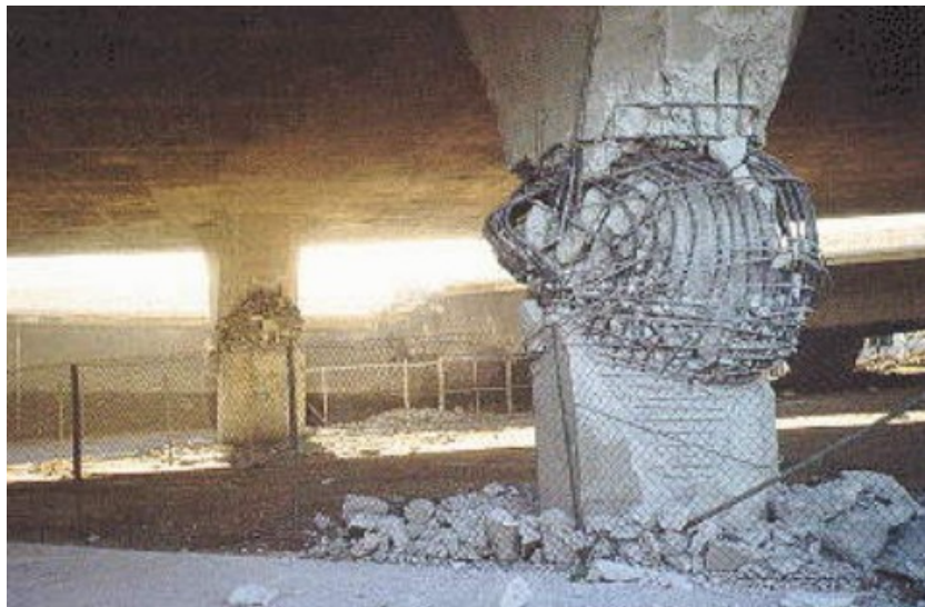
Abbildung 3.2: Versagen einer Stütze beim Northridge Erdbeben 1994
