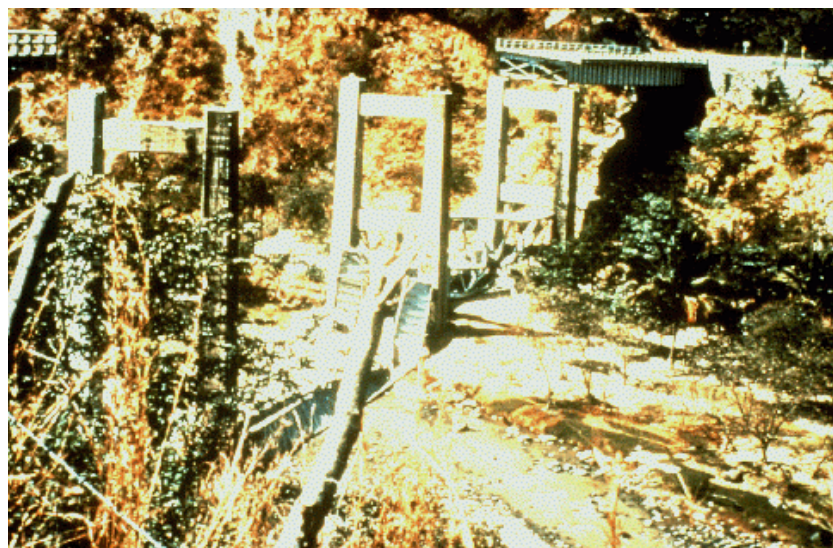
Abbildung 3.8: Einsturz von Brückenträgern nach Erdbeben 1976, Guatemala
