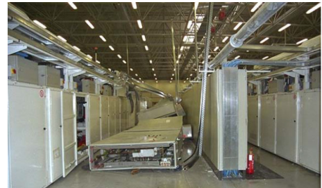
Umgestürzter Schaltschrank, Izmir Erdbeben 1999
