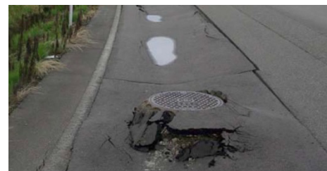
Bodenverflüssigung im Rohrgraben, Japan 2007
