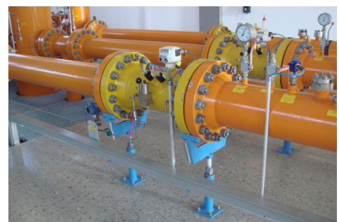
Messstelle im Rohrleitungssystem
